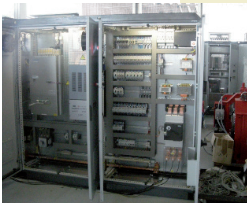
FIG|05 Quadro di automazione.
